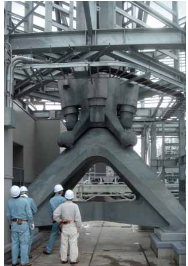
60. Pivot bearing in situ.
